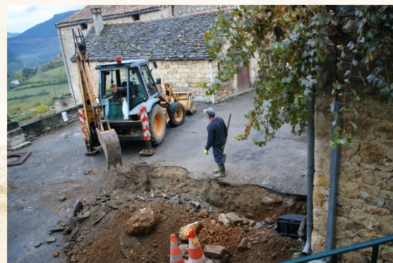
Préparation du chantier par les employés municipaux : remplacement des bouches à clé du réseau d'eau potable, pose de compteurs d'eau et remise en état certaines canalisations souterraines.
