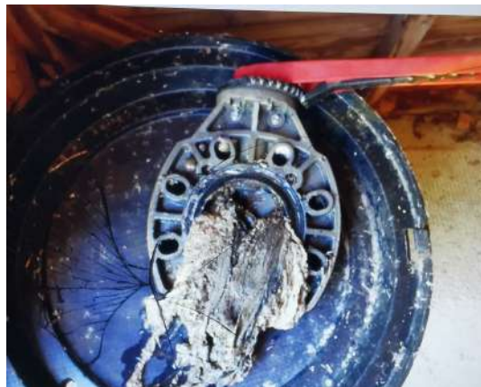
Lingettes obstruant une vanne de la station d'épuration
